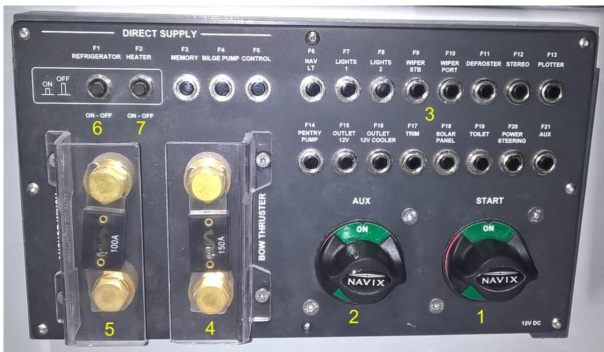
Kuva 9. Pääkytkimet ja sulakkeet
