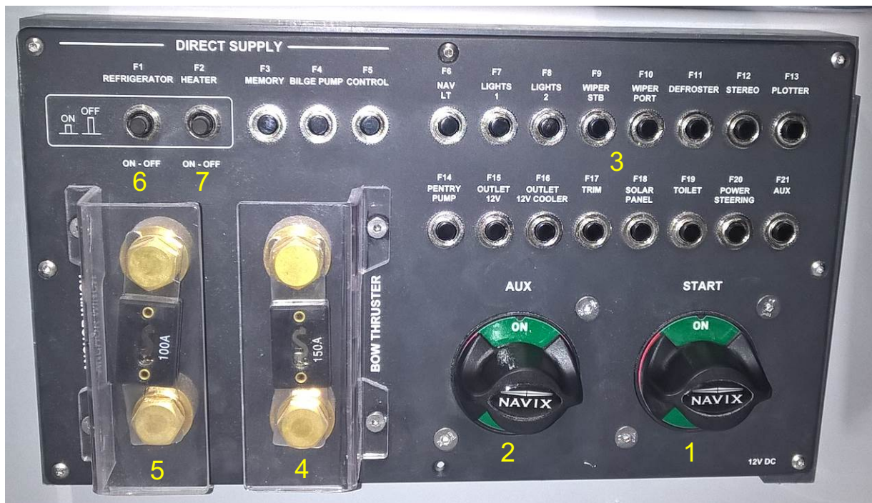
Kuva 9. Pääkytkimet ja sulakkeet
