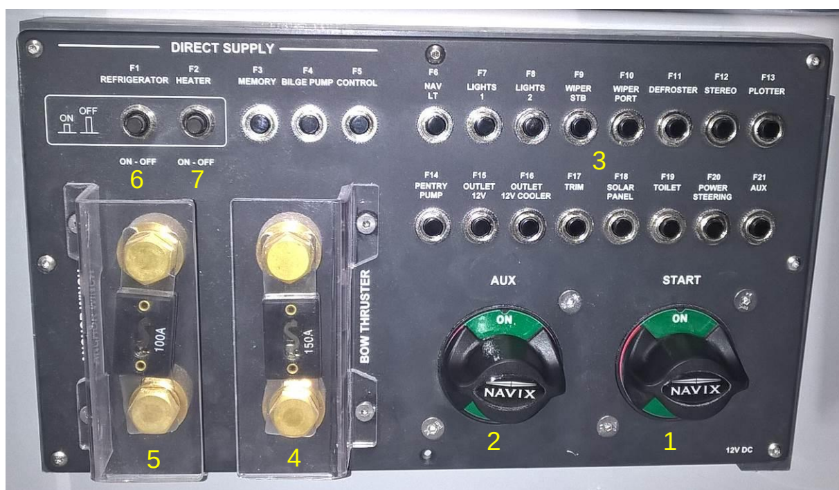
Kuva: Pääkytkimet ja sulakkeet
